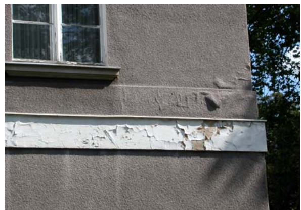
Abgelöste Putzschicht auf der Westfassade (Foto: F. Hesse)
