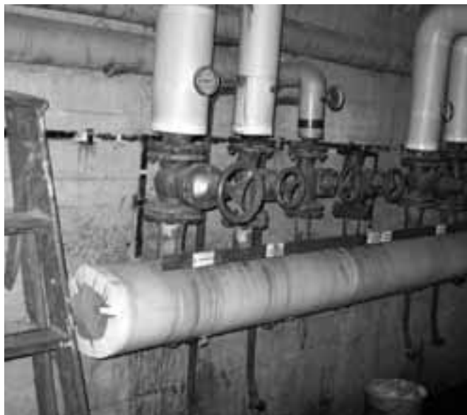
■ Veralteter Verteiler in einer Schule
