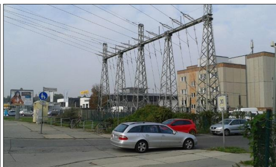
Blick auf das Umspannwerk (Feldmann-/ Hansastraße; im Hintergrund das Autohaus Möbus)
