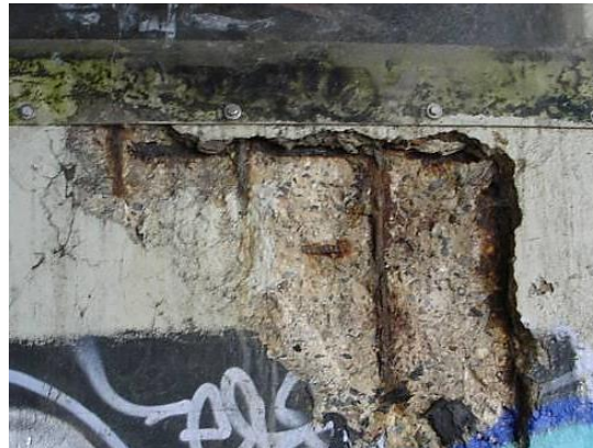
abgeplatztter Beton / freiliegende Bewehrung
