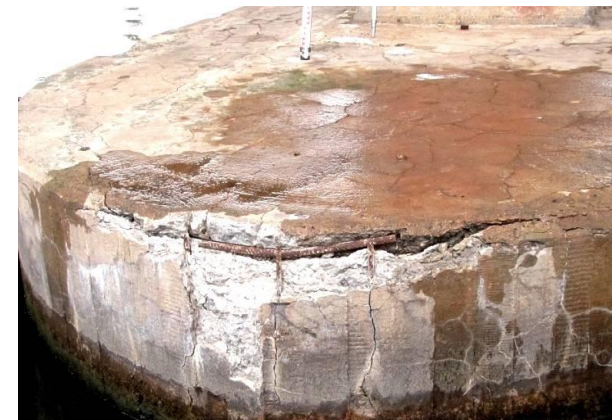
AKR-Schäden am Pfeiler
