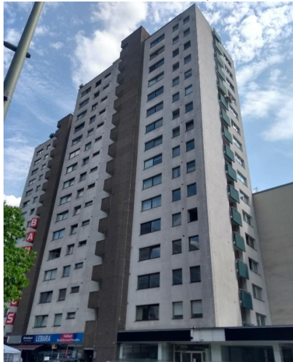
Abbildung 26: Gebäude mit nicht zeitgemäßer Fassadendämmung
