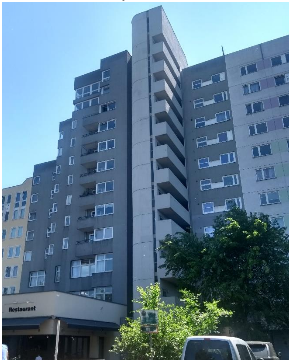
Abbildung 25: Gebäude ohne Fassadendämmung
