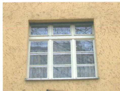
Aufwendig gegliedertes Fenster der Bebauung der 1930er-Jahre an der Ostsee-/ Greifswalder Straße
