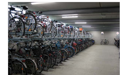
Beispiel: Fahrradparkhaus in Bernau: 566 Stellplätze auf 3 Ebenen, 500 kostenfreie Plätze im „Doppelstockparken“, verschließbare Fahrradboxen kosten 10 Euro/Monat, 45 Schließfächer für Fahrradhelme, -taschen, etc.
