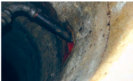
Nicht ausreichend abgedichtete Rohrdurchführung
