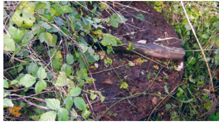
Korrodierte, nicht tagwasserdichte Abdeckung
