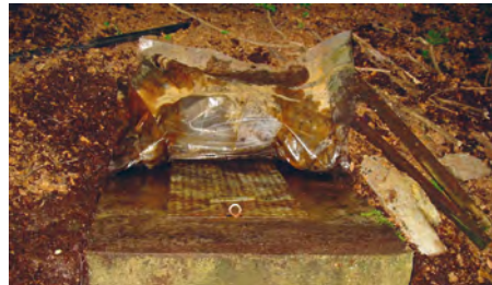
Quellfassung mit undichter Abdeckung und Gefahr des Übersülens (Hanglage)
