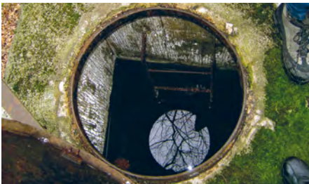
Einwuchs von Pflanzenwurzeln in den Quellschacht
