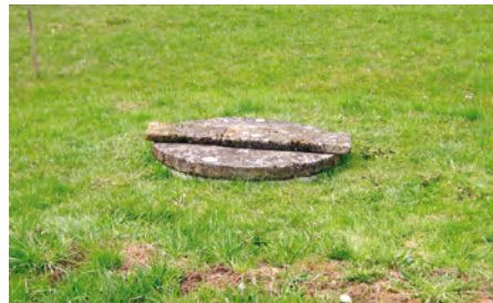
Betondeckel nicht tagwasserdicht
