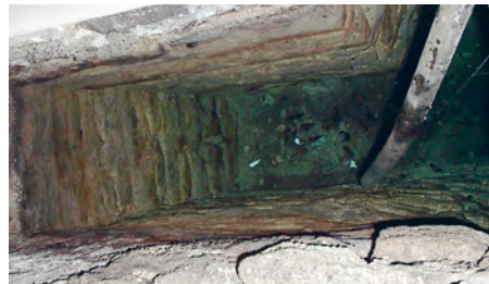
Quellschacht mit baulichen Mängeln
