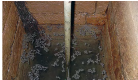
Einwuchs von Wurzelwerk links oben und unbekannte Verunreinigung des Quellsammlers
