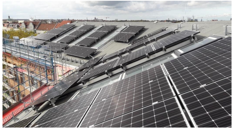
Neu installierte Fotovoltaik-Anlage mit 22 kW peak
